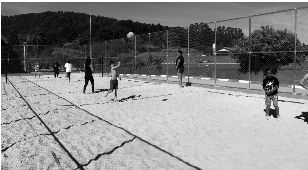
Novas instalações, como a quadra de beach tennis, e a restauração dos decks de madeira fazem parte dos serviços de revitalização do Parque Adib João Dib
